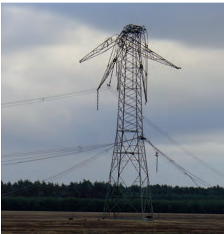
Sturmschaden durch den Orkan Kyrill im Jahr 2007
